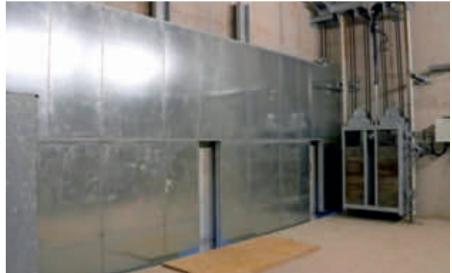
Die Bergstation (oben) wurde so integriert, dass von der Talsohle nur die Einfahrtsöffnung der Materialseilbahn sichtbar ist. Als zusätzliche Lärmschutzmaßnahme wurde eine 5 t schwere, hochfahrbare Schallschutzwand (unten) installiert, die sich nur öffnet, wenn die Fahrzeugmulde ein- und ausfährt.
